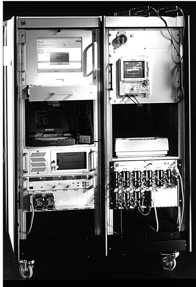
Abb. 3: Integration GPIB-gesteuerter Generatoren/Messgeräte z.B. für Stromverlaufsmessungen
